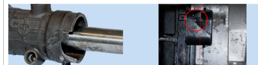
Poškodenia na telese
