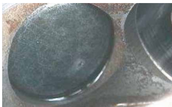
Корозия на корпуса на помпата за високо налягане
