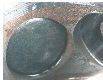
Korozija kućišta visokotlačne pumpe
