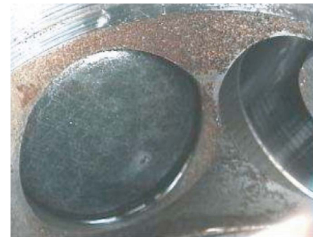
Korozija na kućištu visokopritisne pumpe
